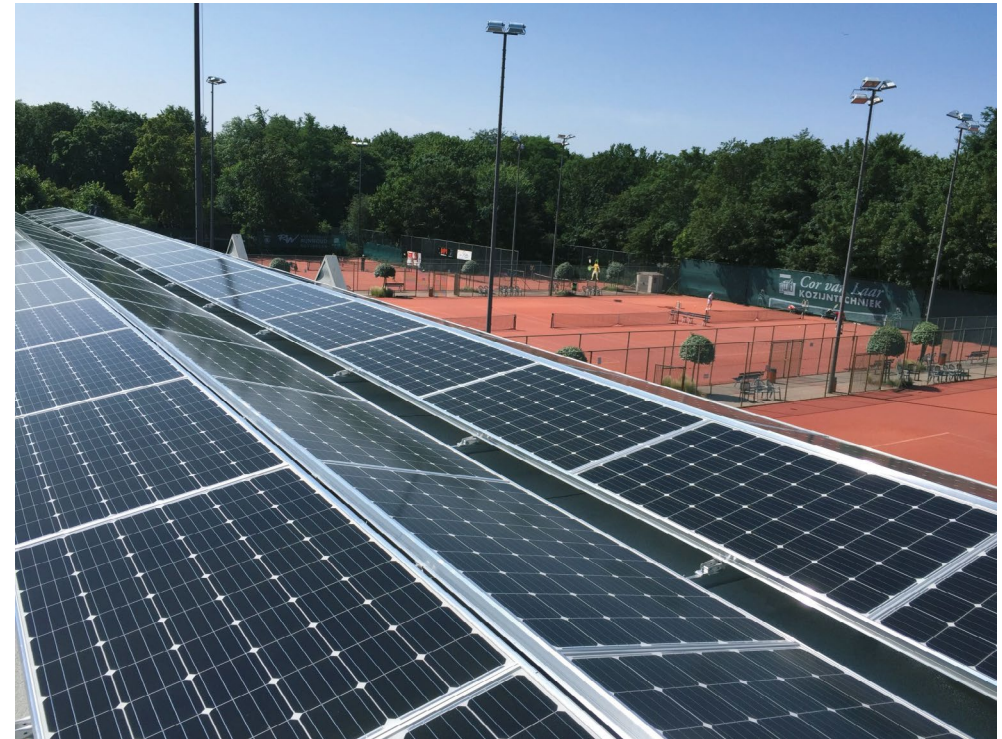
Zonnepanelen op dak van de Haagse tennisvereniging Thor de Bataaf
